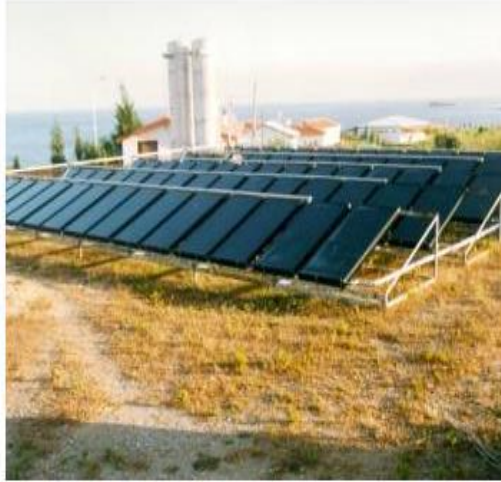
Resim 1 Güneş kolektörlü sıcak su sistemi. (Yumpu Güneş Enerjileri ve Teknolojileri, 2020, s.5)
