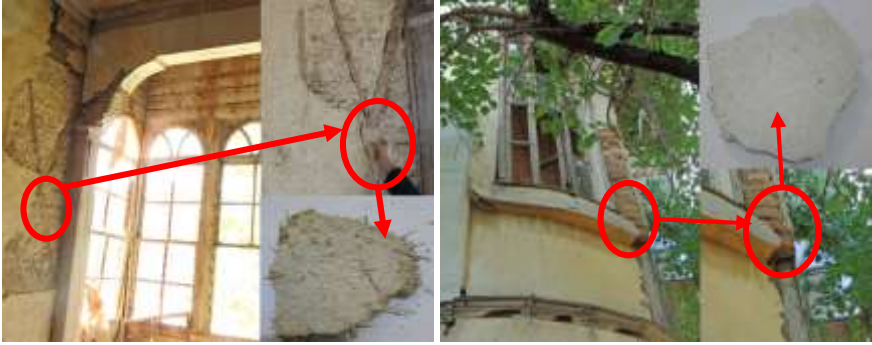
Şekil 1. Birinci kattan alınan iç cephe kaba sıva numunesi (İAS2-solda) ve dış cephe sıva numunesi (DŞS2-sağda)
